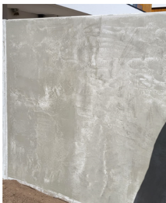
Suporte de betão com defeitos.
